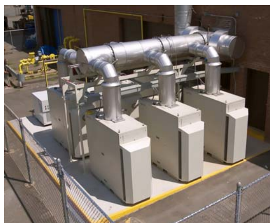
Figura 2-22 Planta de cogeração utilizando 6 microturbinas de 60 kW cada, fornecendo calor a um chiller de absorção 3 de 520 kW (foto: Capstone Turbine Corporation , 2006).
