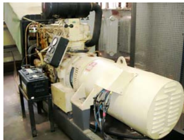
Grupo Gerador - RU Geração de emergência para o RU Fabricante (motor/gerador): MWM/ WEG Tensão: 380 V Potência: 100 kVA
