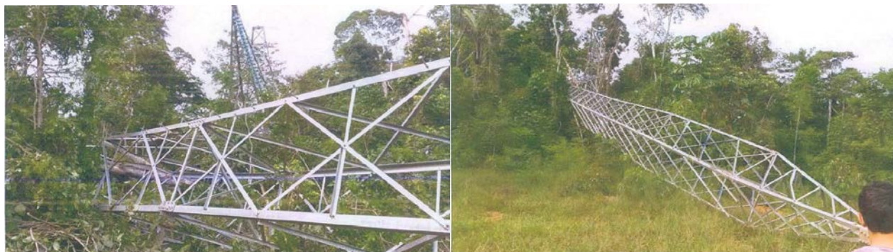
Figura 7 – Torres derrubadas (Fonte: NBTE)
